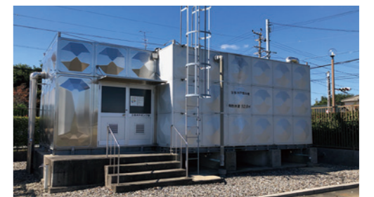
自家水による給水設備(本社事業所)
