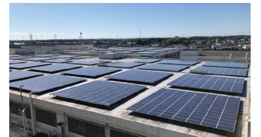
太陽光発電設備(本社事業所)
